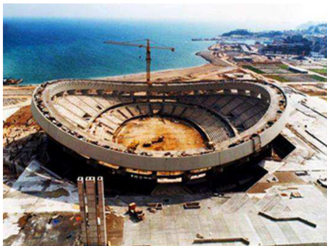
Φωτ. 11.1.1 Το ΣΕΦ σε φάση κατασκευής μετά τη βελτίωση του εδάφους και την κατασκευή της θεμελίωσης
