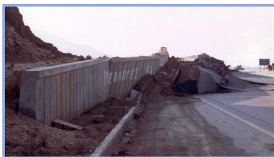
Φωτ. 9.3.1 Πόδας της κατολίσθησης που έχει καταστρέψει μέρος της Ε.Ο.
