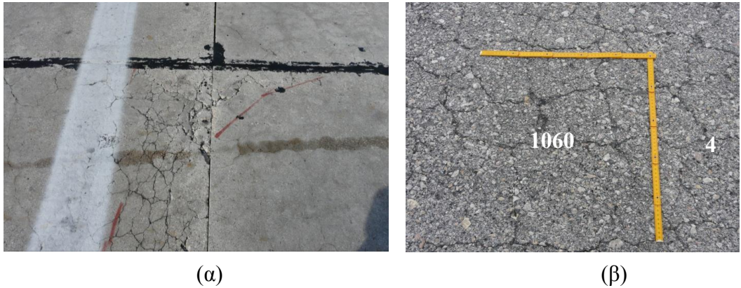
Φωτ. 7.2.1 Χαρακτηριστικές βαριές καταπονήσεις (α) σε οδόστρωμα από σκυρόδεμα και (β) σε οδόστρωμα από άσφαλτο
