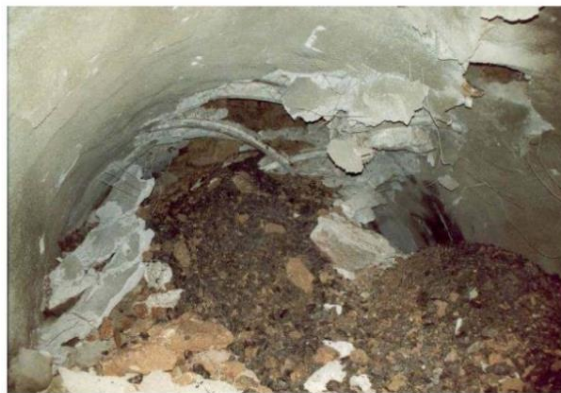
Φωτ. 3.1.1 Κατάρρευση οροφής στο δεξιό κλάδο στη Χ.Θ. 6+625
