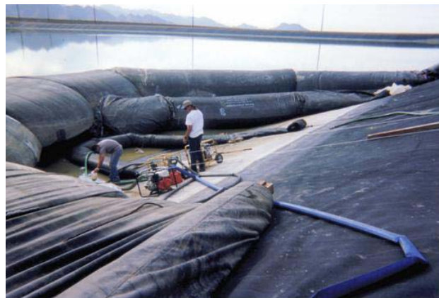
Φωτογραφία 29. Χρήση γεωσωλήνων με νερό για την επισκευή γεωμεμβράνης λιμνοδεξαμενής. Photograph 29. Water filled geotubes for ponds' geomembrane repair (Water Structures Unlimited)
