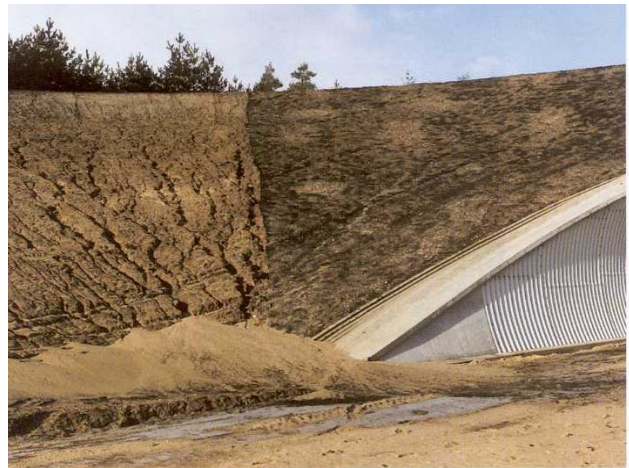
Φωτογραφία 9. Άποψη γειτονικών πρανών με και χωρίς σύστημα αντιδιαβρωτικής προστασίας
