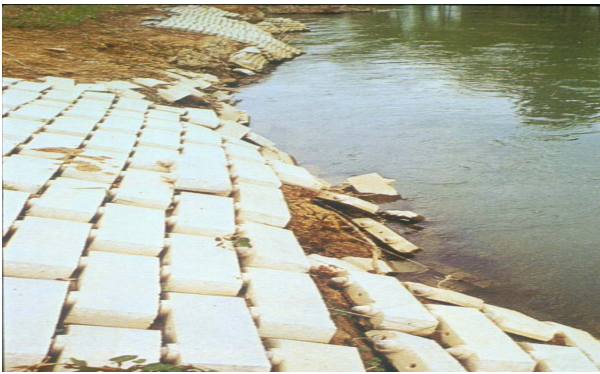
Φωτογραφία 6. Καταστροφή συστήματος προστασίας όχθης καναλιού από διάβρωση. Photograph 1. Destruction of bank protection measures due to erosion.
