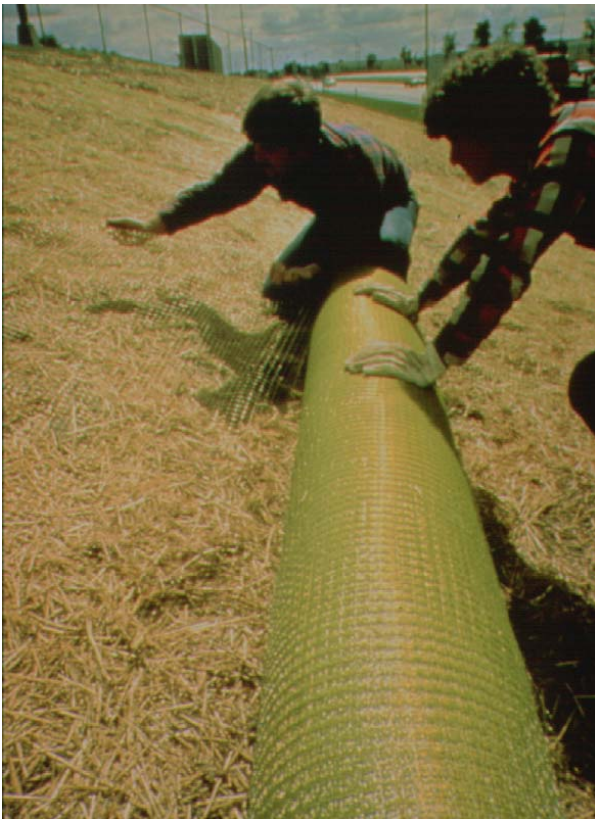
Φωτογραφία 12. Τοποθέτηση αντιδιαβρωτικού τάπητα σε πρανή Photograph 12. Installation of erosion control blanket on a slope
