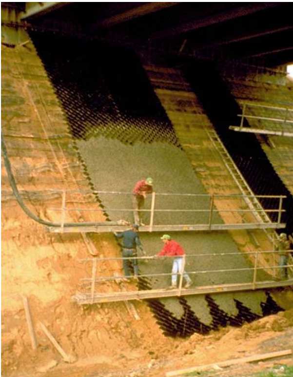
Φωτογραφία 17. Σκυροδέτηση τρισδιάστατων γεωσυνθετικών κυψελών σε απότομο πρανές. Photograph 17. Concrete pouring within the geosynthetic cells installed on a steep slope.
