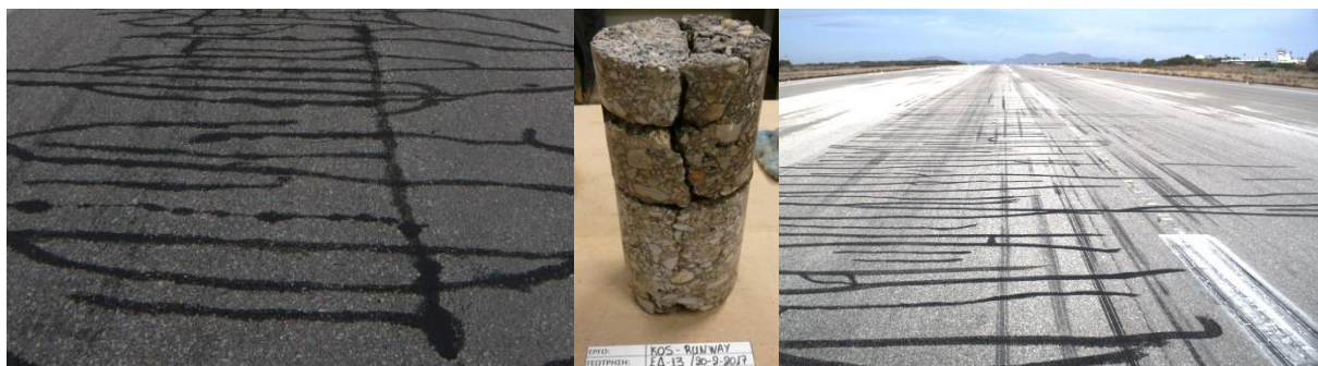
Φωτογραφία 1. Τυπική όψη επιφάνειας και ενδεικτικός πυρήνας από το εξεταζόμενο τμήμα. Picture 1. Typical view of cracked surface and indicative core from the examined sub-section.
